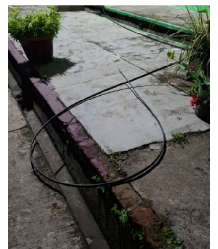
Los técnicos colocaron nuevos cables que nuevamente fueron destruidos
