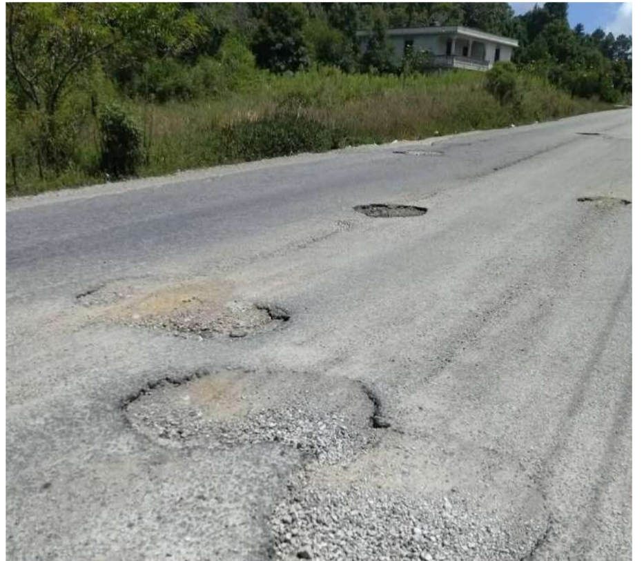
Tramos deteriorados ponen en peligro a quienes transitan diariamente
