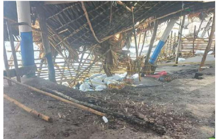
Oleaje intenso daña negocios y estructuras frente al litoral
