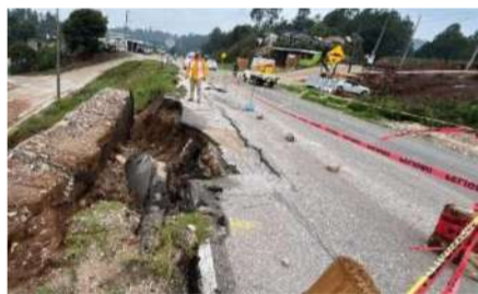
Paso restringido entre Teopisca y San Cristóbal por caída de material
