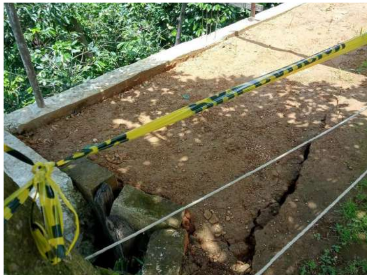
Personal de Protección Civil realizó recorridos preventivos para evaluar daños en la zona
