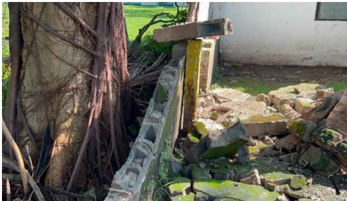
El desplome ocurrió durante el receso vacacional, evitando una posible desgracia
