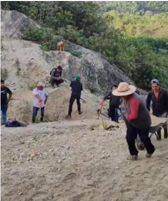
Habitantes rellenan baches ante la falta de atención municipal
