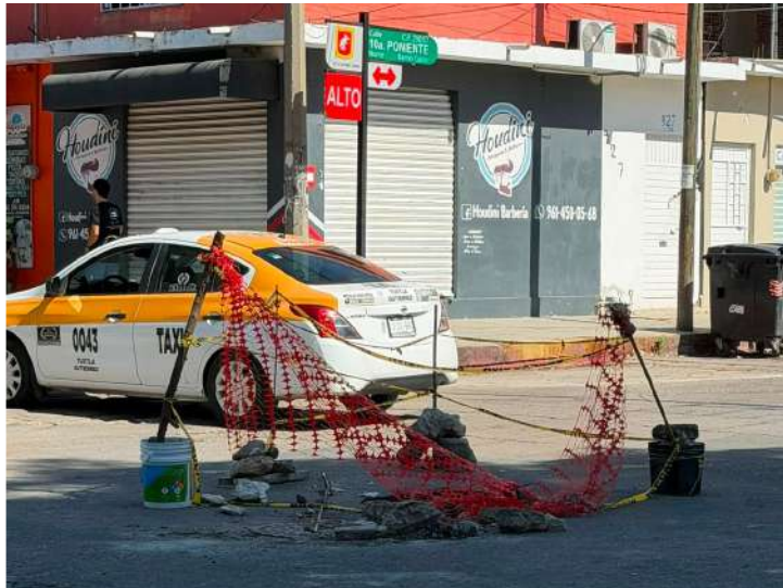
Hundimientos, aguas residuales y temor mantienen inconformes a habitantes
