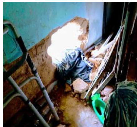
Delincuentes rompieron una pared para ingresar a la vivienda
