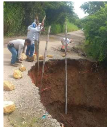
Derrumbe complica tránsito hacia Benemérito
