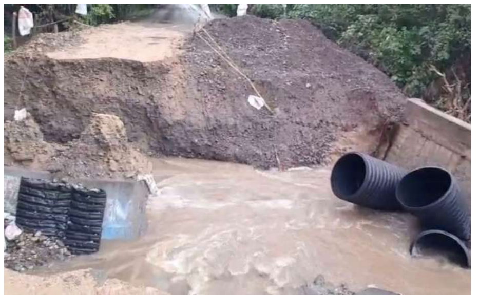
El temporal arrastró alcantarillas y material de rehabilitación en El Terrero
